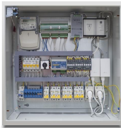
Рисунок 1 - Коммуникационный шкаф УПП
